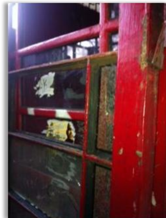
Spuren des Vandalismus
