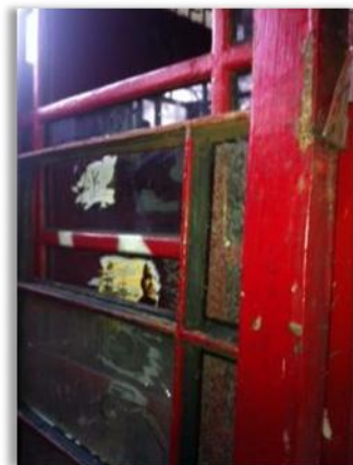
Spuren des Vandalismus
